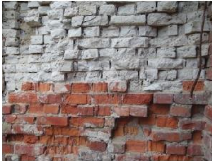
Рисунок 2.4 Фрагмент пошкодженої стіни будівлі
