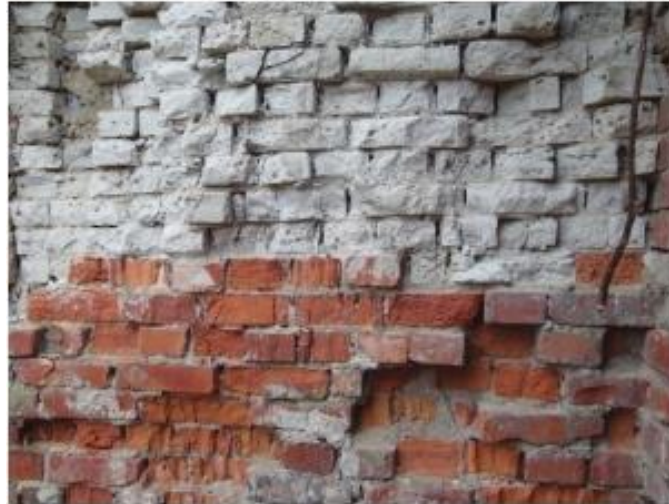
Рис. 1.1 Фрагмент пошкодженої стіни будівлі
