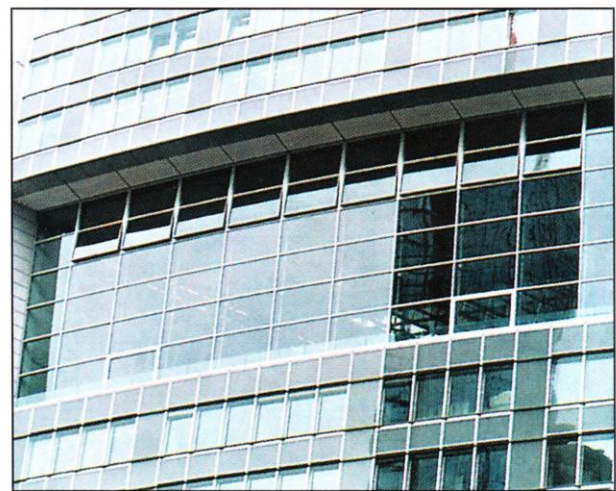
» Остекление зимнего сада высотой 14 м и шириной 36 м (вверху – автоматически открываемые окна)
