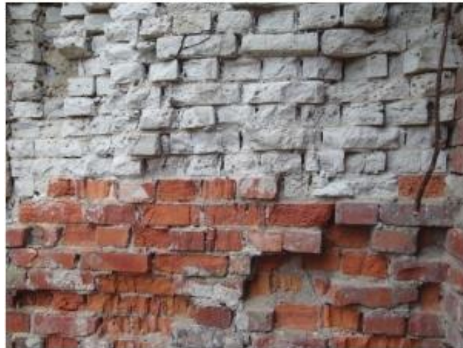
Рис. 1.1 Фрагмент пошкодженої стіни будівлі
