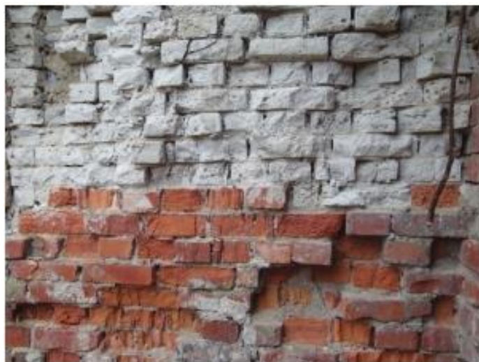
Рис. 1.13. Фрагмент пошкодженої стіни будівлі
